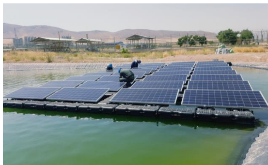
شکل ۷. نیروگاه خورشیدی شناور شرکت پتروشیمی مهاباد
