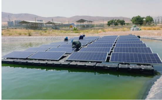
شکل (۷). نیروگاه خورشیدی شناور شرکت پتروشیمی مهاباد
